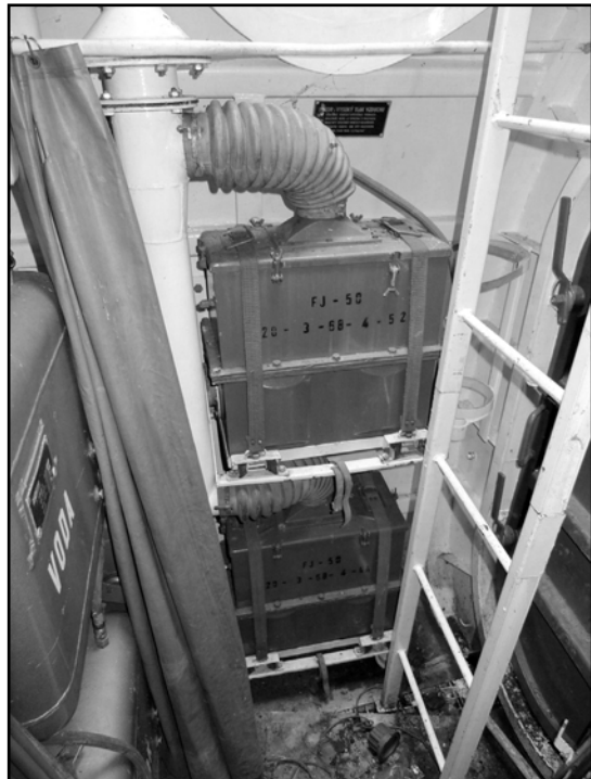
5) Filtroventilační zařízení úkrytu PÚ-68 v Piešťanech. (foto autor)
