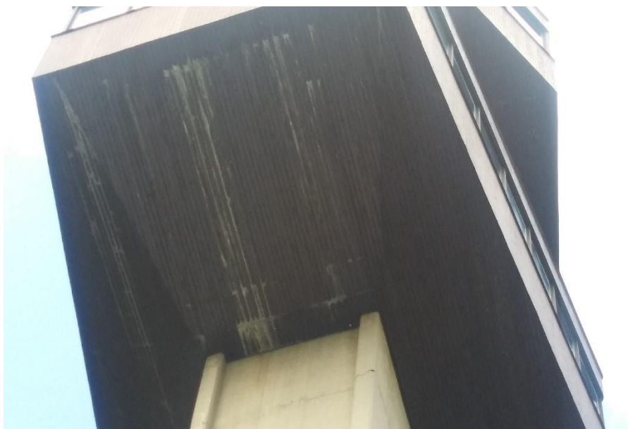
Obr.: Pohľad na zatečenie podhľadu kupoly
