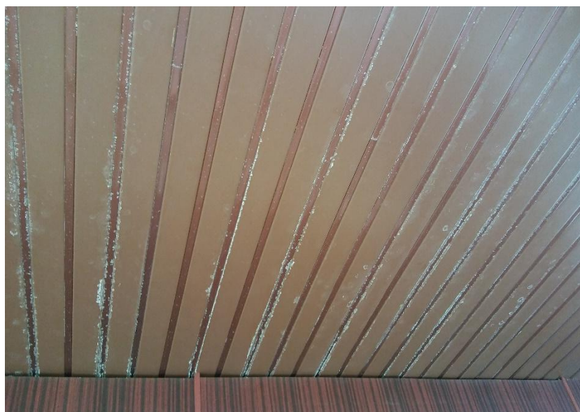
Obr.: Pohľad na zatečenie podhľadu vo vnútri kupoly
